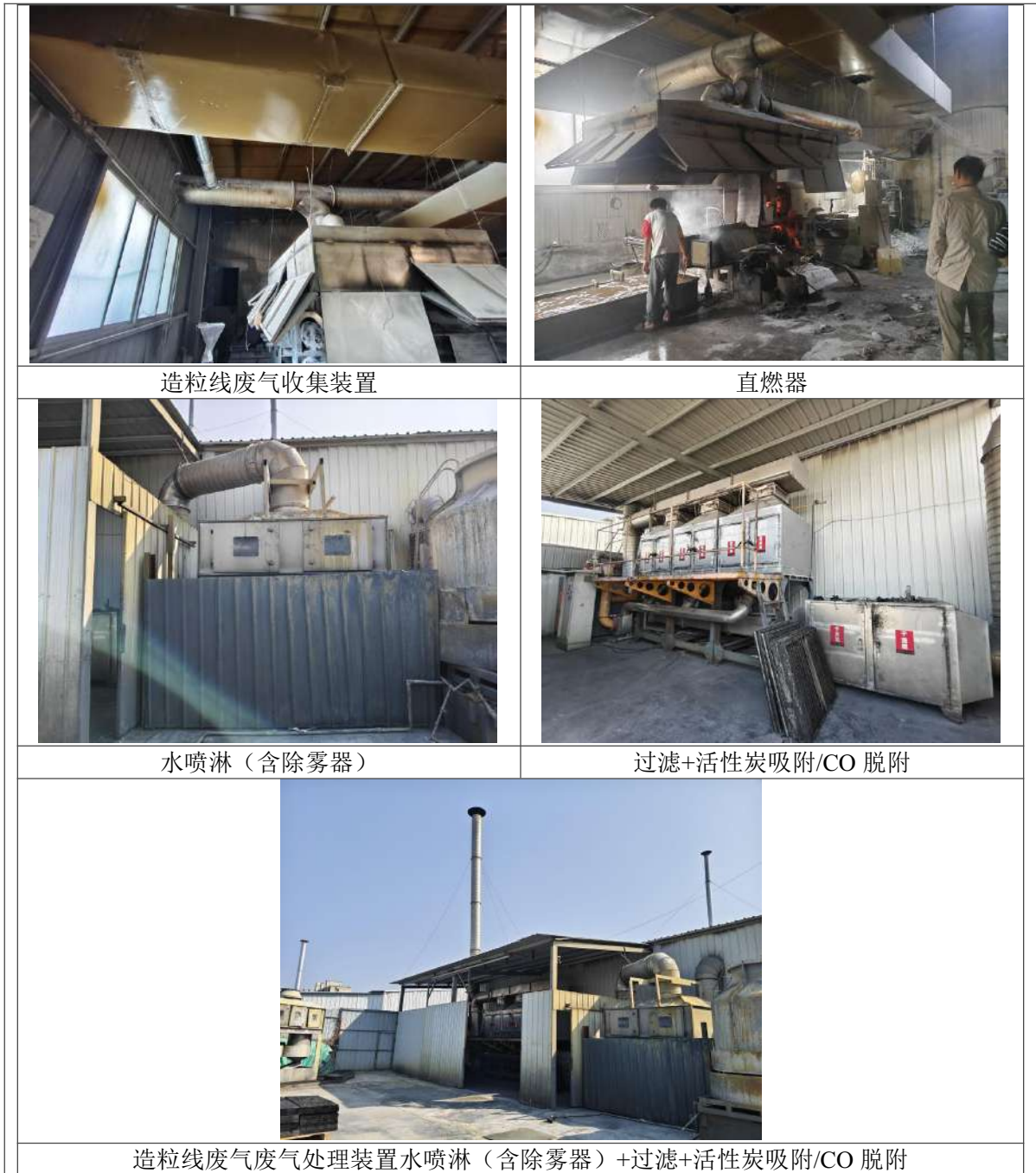
图 3-1 废气治理设施图
