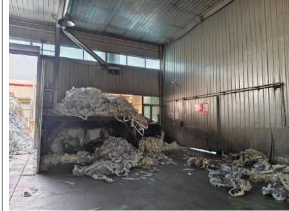
原料库废气收集装置
