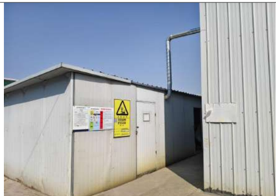
危废库废气收集装置
