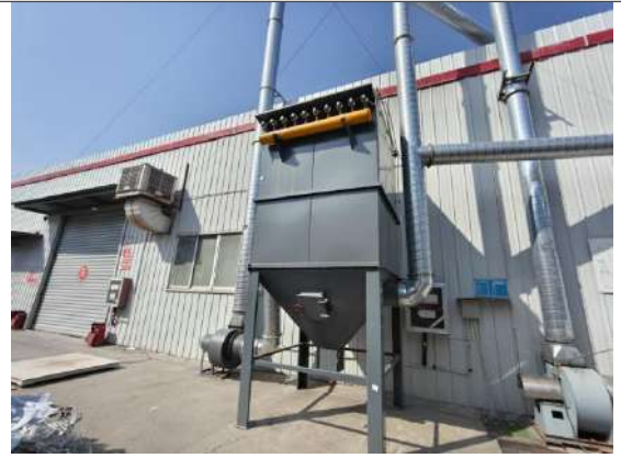
破碎工序废气处理装置“袋式除尘”
