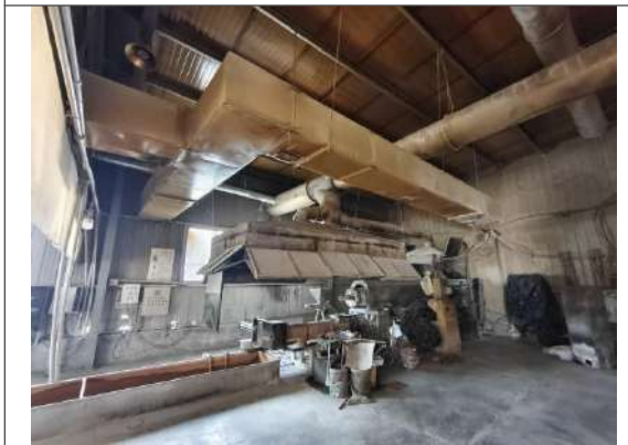
造粒线废气收集装置
