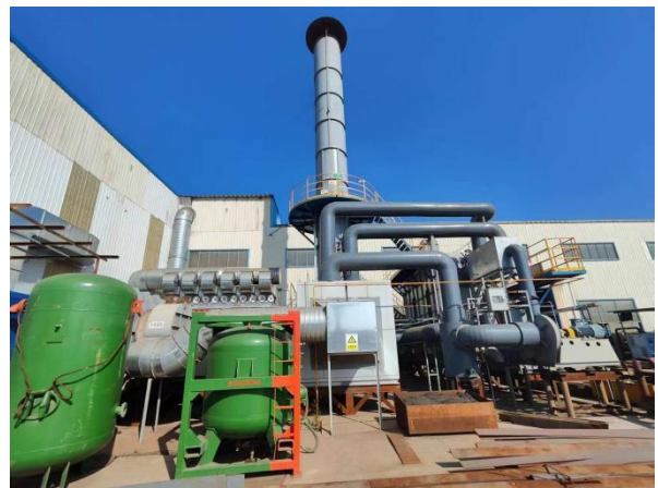
喷漆房废气治理设施照片
