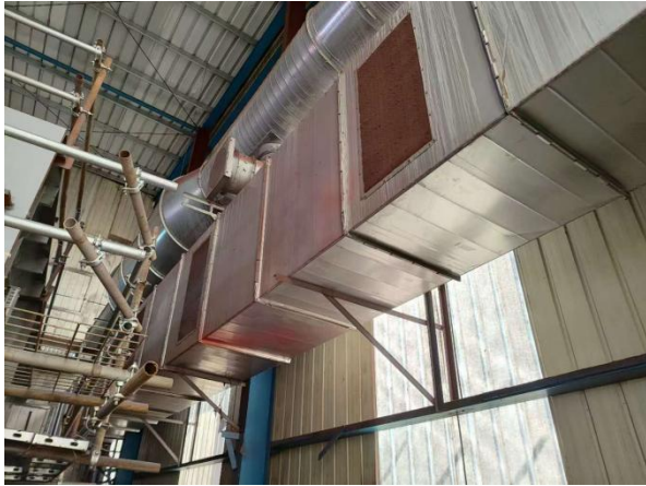
废气收集装置照片
