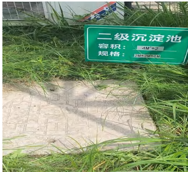
图 3-2 二级沉淀池照片
